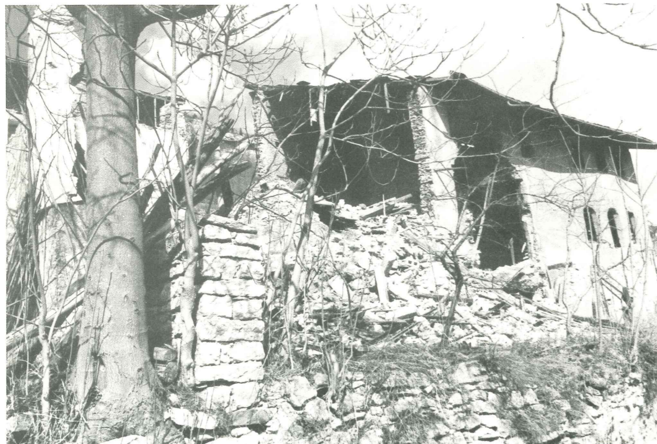
Foto 1 - Frana di Moia - Particolare lesioni casa Seiser.
