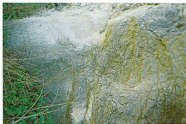
Fig. 16 - Alveo del Lago di Loppio. Su un masso, originariamente sommerso, sono presenti le vermicolazioni, tipica forma di corrosione biologica.
